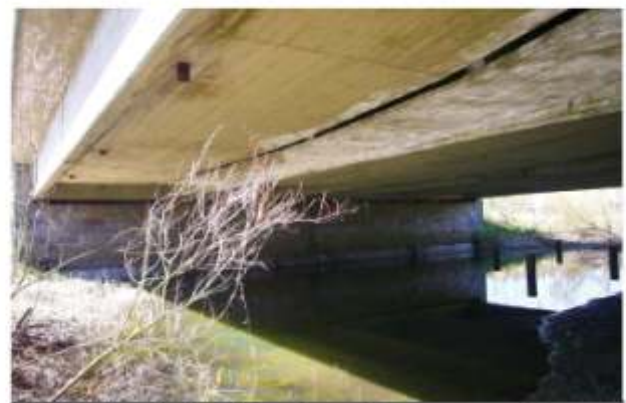
„Brücke über die Ihna“; Die stehen gelassenen Betonstützen im Hintergrund zeugen noch von der Bauphase (2007)
