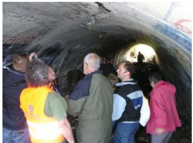
Nur gelegentlich sind Setzungsrisse aufgetreten.
